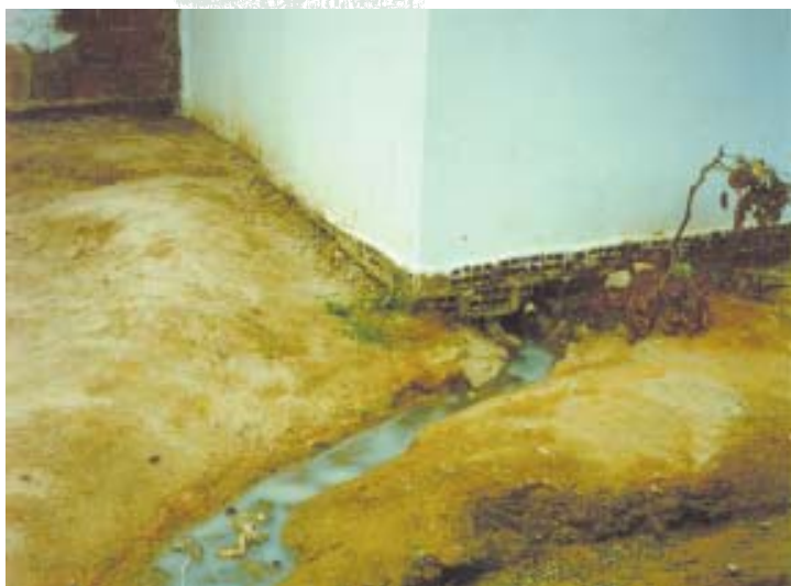
ESGOTO LANÇADO a Céu Aberto
